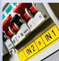
Fordelingskasser og koblingspaneler
